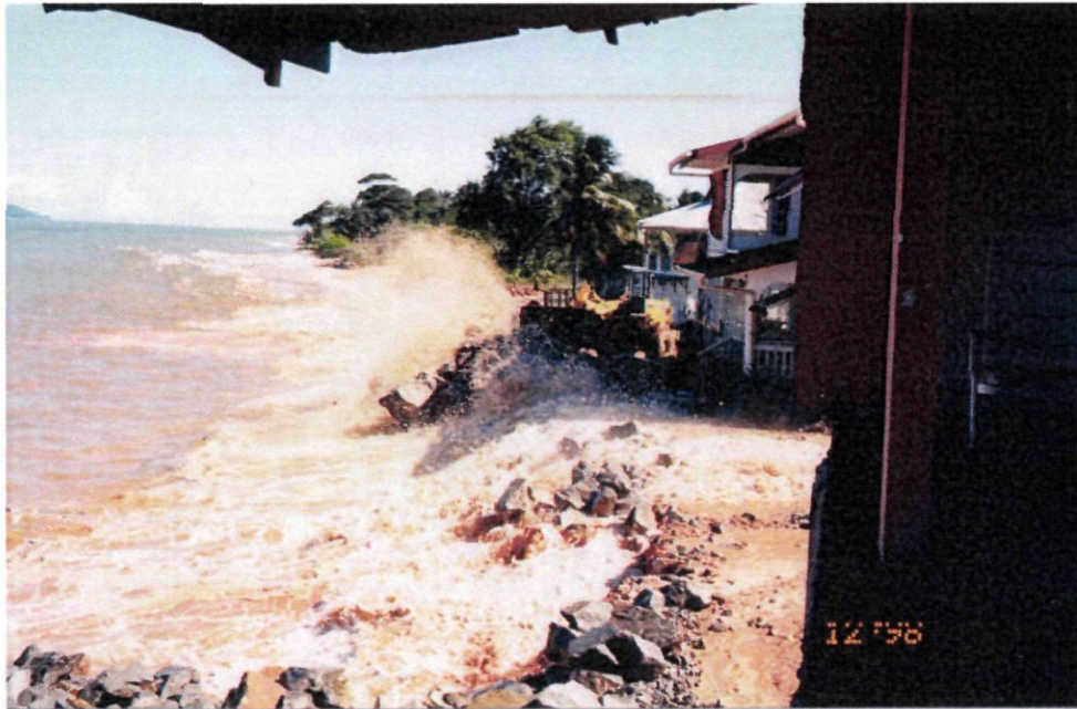
Figure 42 - Événement érosif de Décembre 1998 dans le secteur de Montjoly (BRGM, 1998)
