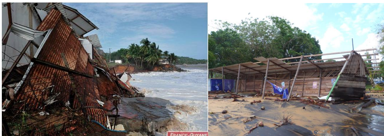
Figure 24 : Extension de la rhumerie beach détruite à gauche, extraite de l'édition du 16 janvier 2013 du journal France Guyane et hangar de l'Apcat en partie détruit à droite (©France Guyane et Moisan, 2013).
