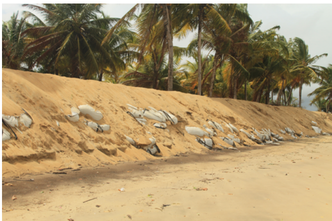
Figure 5.13 : Big Bags mis à nu, en novembre 2017 (cliché Louis Portier, 2017)
