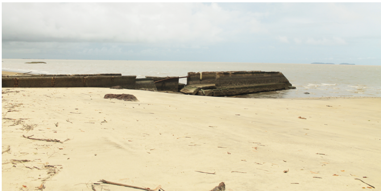
Figure 6.33 : Exutoire brisé devant la cité 205, novembre 2017 (cliché : © Louis Portier)
