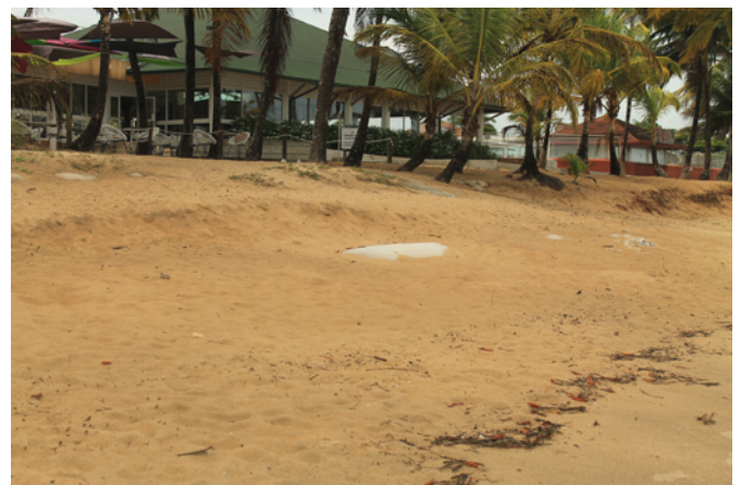
Figure 5.15 : Boudin géotextile apparent sur la plage des Roches (Kourou), en novembre 2017 (cliché Louis Portier, 2017)
