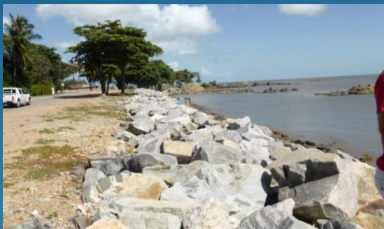
Enrochement anse chaton – mis en œuvre en urgence : (insuffisamment ancré / pas de sous-couche ) -> glissement de la structure (photographie ARTELIA 2016)
