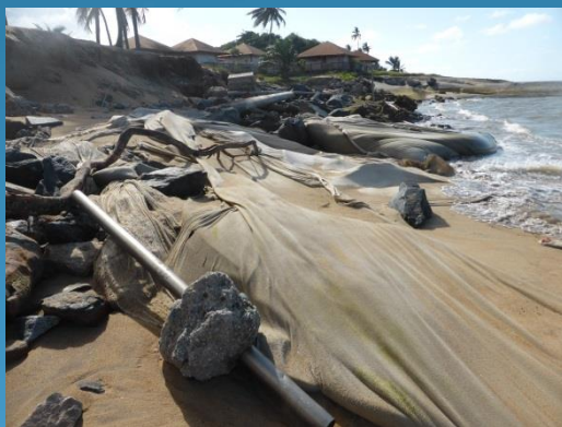
Destruction du stabilage de l'hôtel des Roches à Kourou (Aout 2016 – photo ARTELIA)
