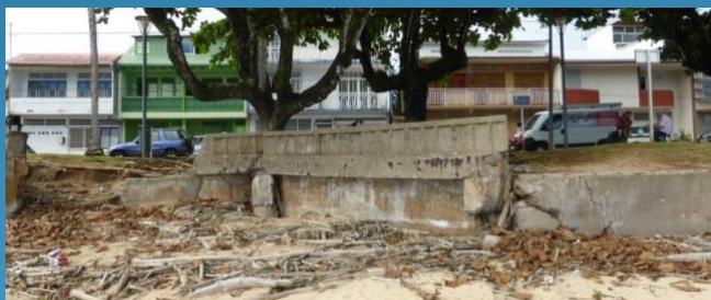
Perré béton en ruine (photographie ARTELIA 2016) – endommagé peu de temps après sa construction dans les années 80
