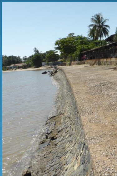
Perré maçonné ancien (bagnards) insuffisamment entretenu (disjointoiement - photographie ARTELIA 2016)
